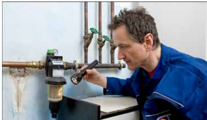
Die Trinkwasser-Installation im Eigenheim sollte regelmäßig durch einen SHK-Fachbetrieb überprüft werden. Foto: ZVSHK/txn
